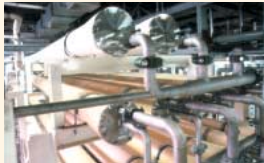
濃縮水を回収・再利用するために増設した設備(高知カシオ)
