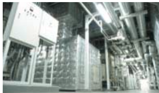
高知カシオ(株)の空調設備
