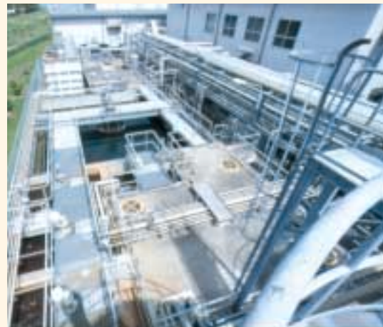
高知カシオ(株)の排水処理設備
