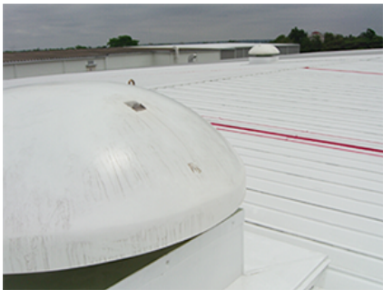
廃熱用電動ルーフファン
