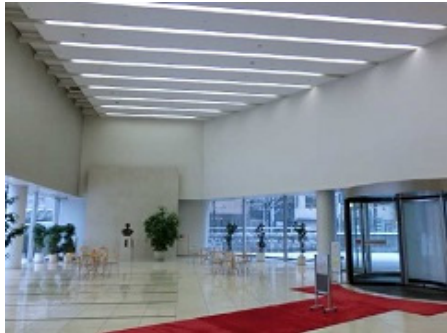
初台本社ロビーのLED照明
