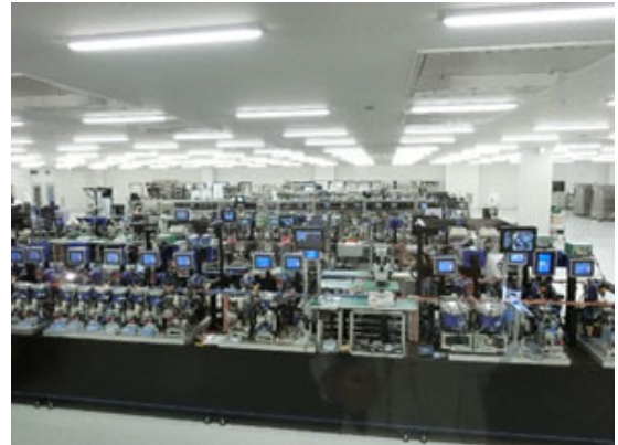
最新式空調設備のクリーンルーム
