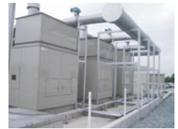
■コジェネレーションシステム
