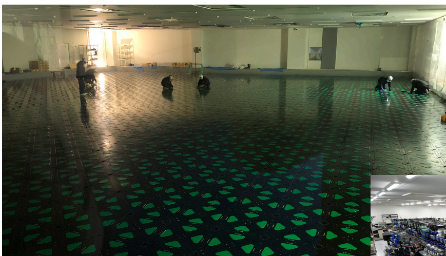
山形カシオ新工場 時計製造フロアの防震システム
