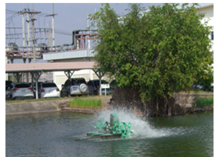
貯水池の空気取込用攪拌機
