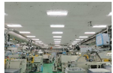
山形カシオ工場のLED照明
